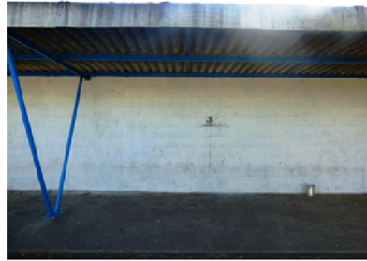
Une tache sur le mur du coin vélo
